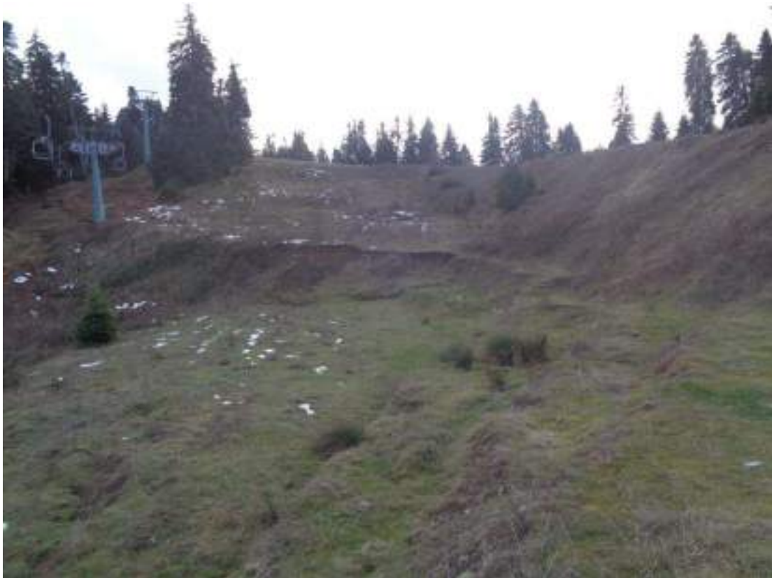
Φωτ. 1: Άποψη στέψης κατολίσθησης κατάντη 6 ου πυλώνα.
