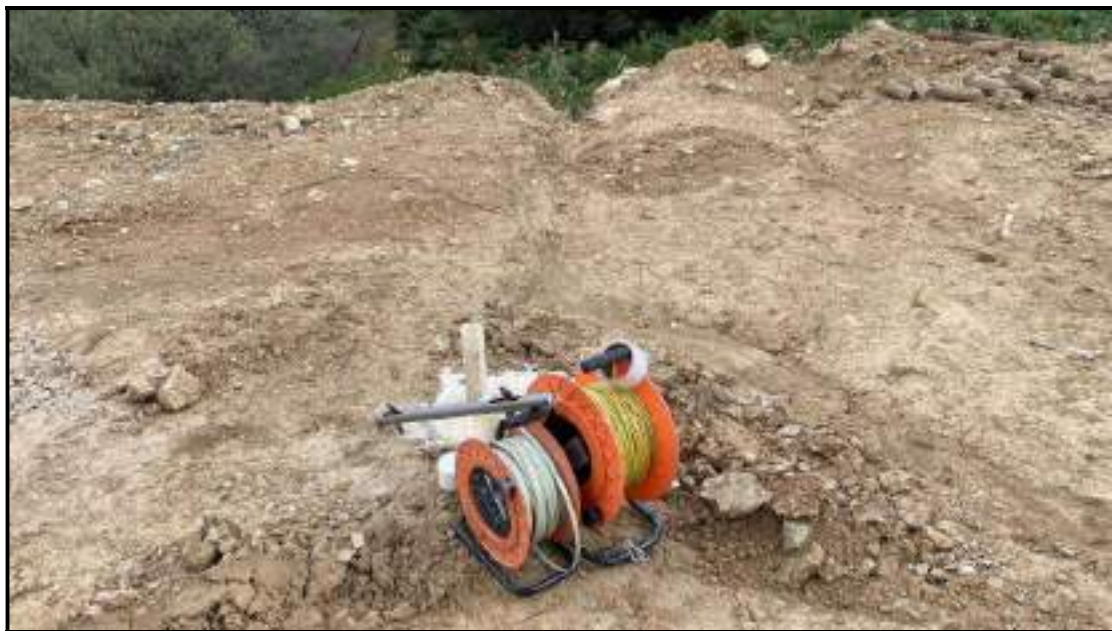
Εικόνα 5.3.1.4-1. Χρησιμοποιούμενος εξοπλισμός. Διακρίνεται ο κλισιομετρικός σωλήνας στη θέση Γ-2 η τορπίλη του οργάνου και το καλώδιο μεταφοράς των μετρήσεων.
