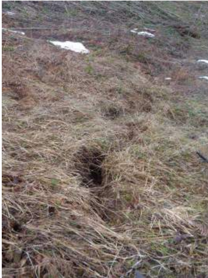
Φωτ. 23: Ρωγμή στην στέψη της κατολίσθησης μετά την κακοκαιρία <<DANIEL>>.
