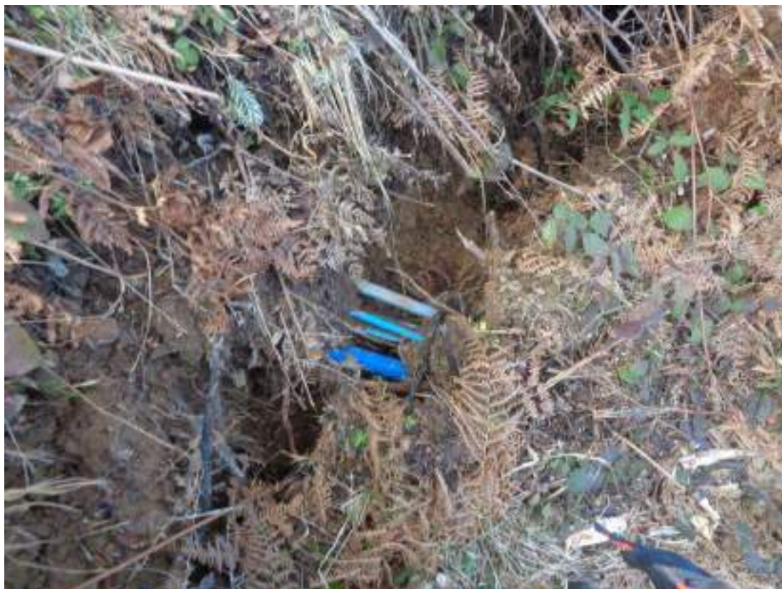
Φωτ. 24: Αβαθής ερπυσμός ανάντη του 6 ου πυλώνα μετά την κακοκαιρία <<DANIEL>>.
